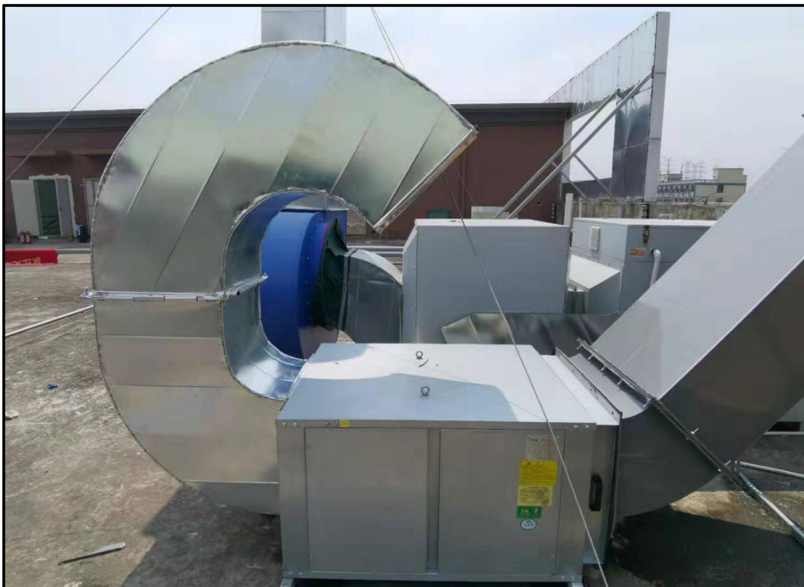
图4-2 项目废气治理设施图
